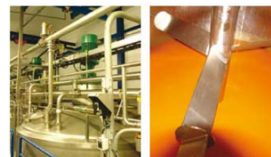
Links: In dit Intermediate Tank Farm bij Cargill Flavor Systems vindt de blending plaats van vruchtensapconcentraat. Rechts: De blending door middel van roerwerken in een van de tanks in Cargill.
