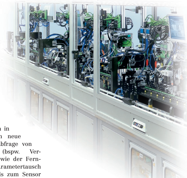
Abb. 3: Beispiel einer Maschinenverdrahtung
